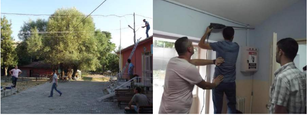
Resim 7: Kazı Evine Yapılan İnternet Bağlantısı ve Switch Bağlantıları Çalışmaları
